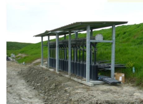
Sottostazione di regolazione del biogas
