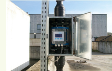
Nuovo contatore posizionato in ingresso alle cisterne di stoccaggio
